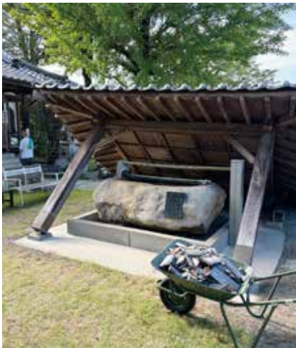
倒壊した手水舎の屋根(九州西教区提供)
